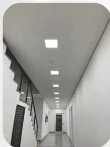
Forro em Drywall
